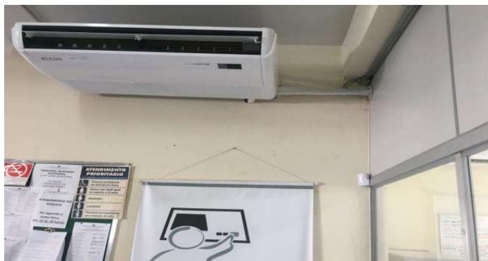
Após a instalação de ar-condicionado
