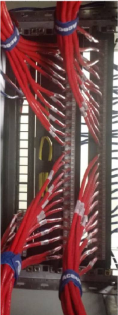
FOTO 04 – Distribuição bilateral dos cabos
