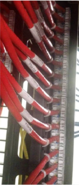
FOTO 03 - Disposição e Travamento dos Cabos
