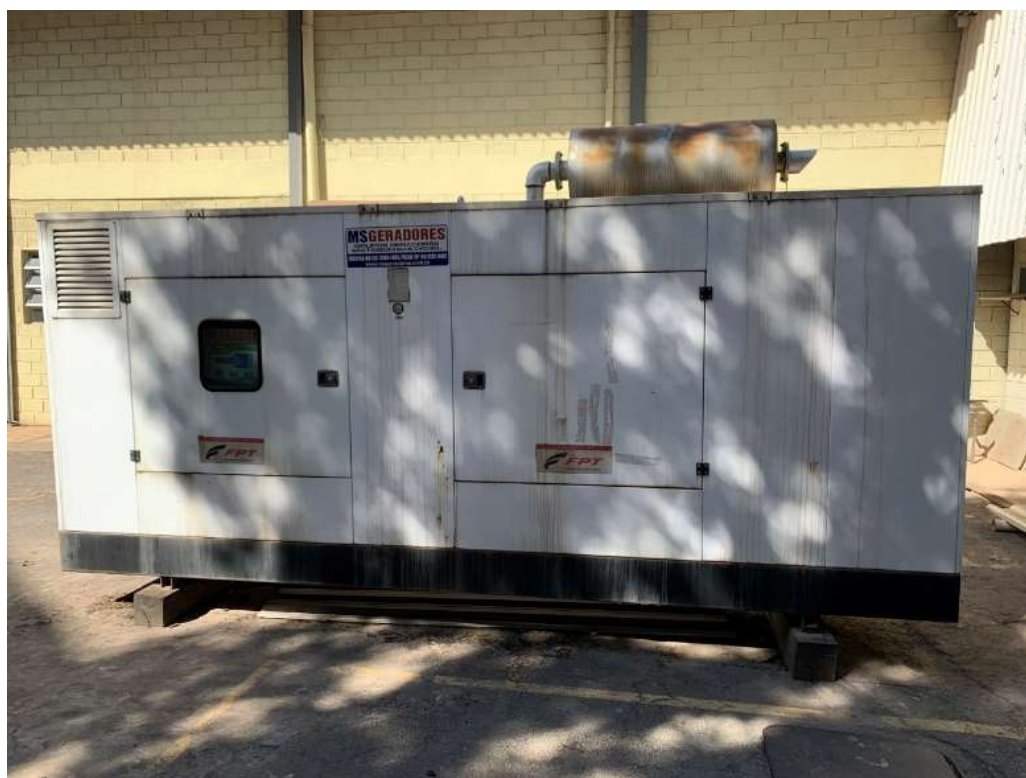
Figura 12: Gerador à diesel cabinado, potência 450 kVA.
